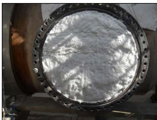
Manta de fibra cerámica KAOWOOL en boca de hombre de planta petroquímica
