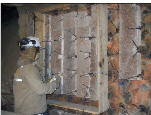
Placas Ceraboard 100 como capa aislante en planta cementera
